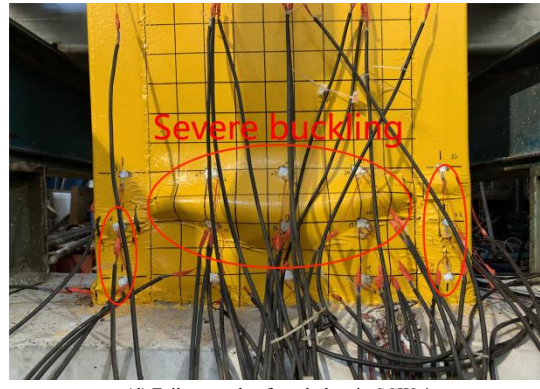
(d) Failure mode of steel plate in SCW-4
