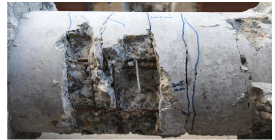
(d) Tensile side of core concrete
